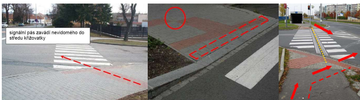
Obr. 15 Příklady špatně provedených přechodů [5]
